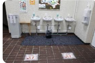
食堂前のハンドドライヤーを使用中止とし、 ペーパータオルと消毒液を設置
